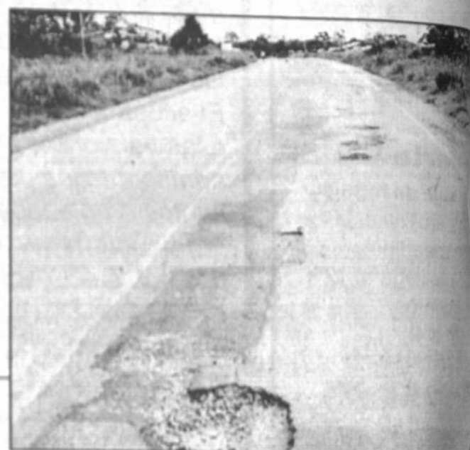
El principal corredor interoceánico está deteriorado.
