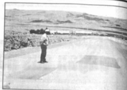
Algunos lugares ya presentan destrozos, antes de la explotación oficial.
