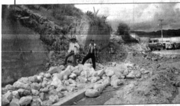
La falta de canalización y drenajes adecuados provocaron los problemas, señala Bartos.
