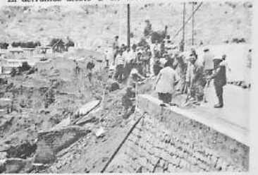
Debido a las torrenciales lluvias, cedió ayer un muro de contención de la avenida Quintanilla Zuazo.
