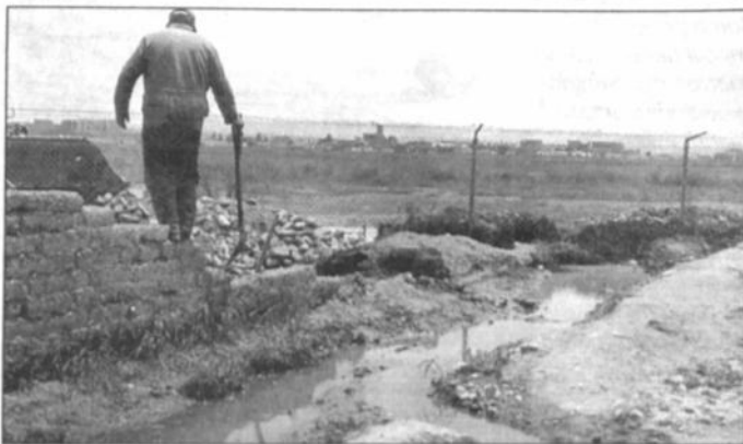
Algunos vecinos para evitar que sus murallas sean desplomadas por la fuerza del agua prefirieron derribarlas.
