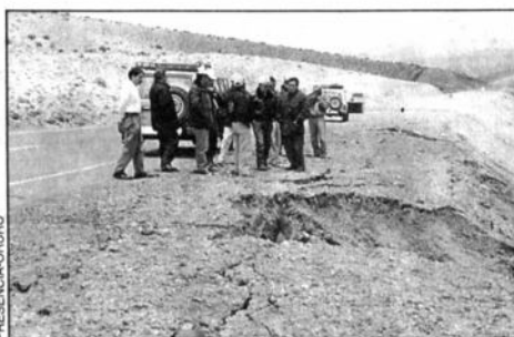
Autoridades y técnicos orureños inspeccionan la carretera Patacamaya-Tambo Quemado. Se observa el agrietamiento del terreno de la bermá.
