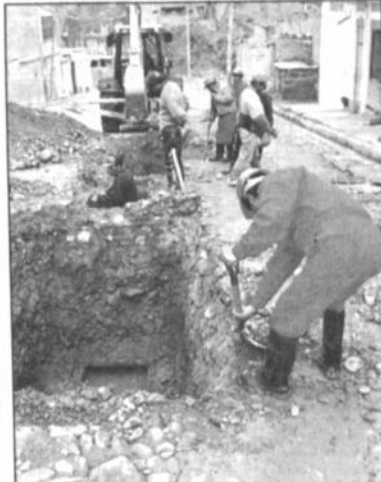
Los destrozos causados por las últimas lluvias.
