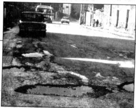
La vía necesitará una reparación total para que esté en óptimas condiciones.
