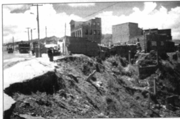
La avenida Juan José Torres, muchos millones para hacerla, más para repararla.
