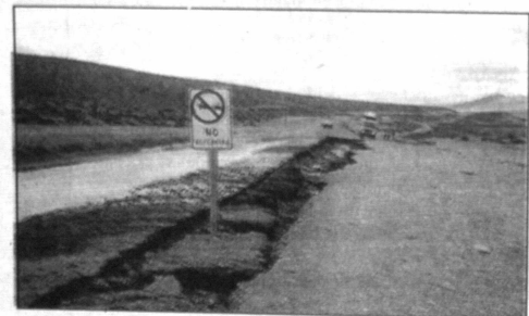
Sin mantenimiento, todo llega a deteriorarse.
