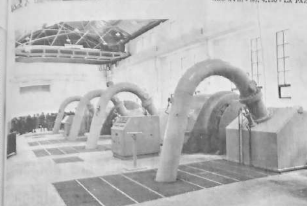
Una parte de las instalaciones de la central hidroeléctrica de Parca, ubicada en el valle de Zongo, perteneciente a la Compañía Boliviana de Energía Eléctrica. Su inauguración se realiza ayer y tiene una capacidad de 27,900 KW que contribuirá al mejoramiento de la provisión de energía eléctrica de La Paz. (Información completa en la página 5).
