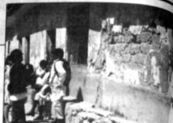
Estas paredes necesitan ser refaccionadas seriamente.
