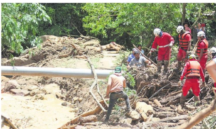
Un árbol ocasionó la rotura del oleoducto próximo al río Cuevas, lo que desató pánico
