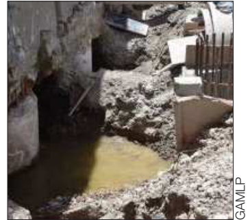
Uno de los pilotes deteriorados.
