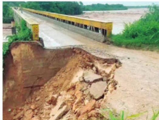
Así quedó parte de la rampa de acceso al puente en Colpa Bélgica
