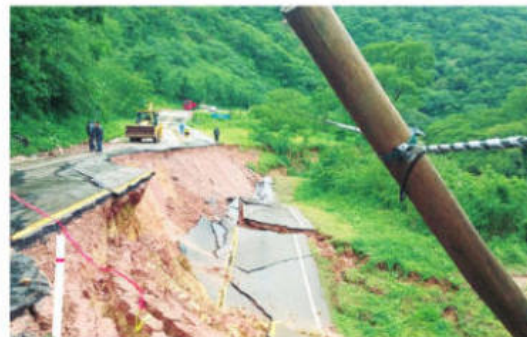
Parte de la plataforma cedió en el sector de Bermejo
