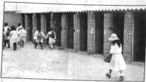
Las letrinas inutilizables, las puertas rotas y los bancos de las aulas en mal estado, acompañaron este año a los estudiantes de Villa San José de Yunguyo.
