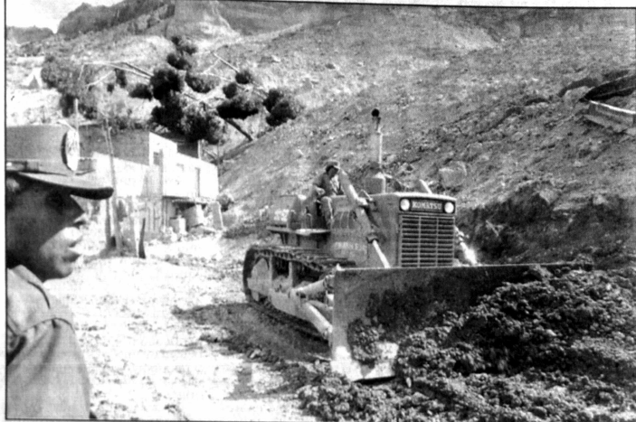
Las topadoras no fueron suficientes para evitar los deslizamientos.
