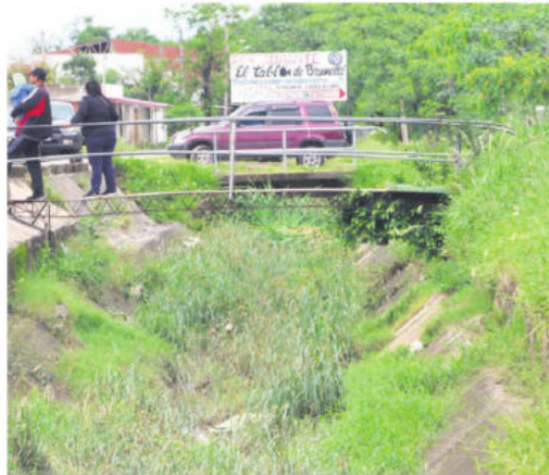
Los vecinos de la zona sur piden limpieza de sus canales de drenaje
