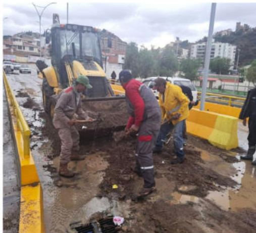
En Sucre, la lluvia del martes dejó lodo y sedimento
