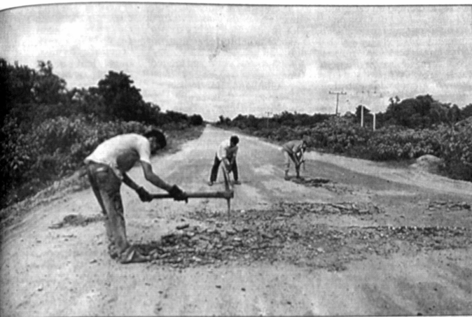
Las fallas e irregularidades son cada vez más evidentes en la medida que se recorre el camino de acceso al Chapare. La palabra del Servicio de Caminos todavía no se ha escuchado.
