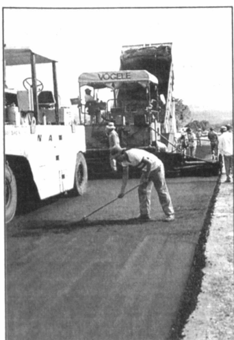
La consultora Hidroservice-Connal no denunció irregularidades en el tramo Chimoré-Yapacaní, que ahora presenta: oxidación, fisuras y la presencia de lo que se denomina piel de cocodrilo; estas deficiencias son sometidas a una reparación constante que no solucionan el problema de fondo.
