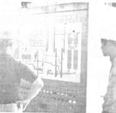
Cada uno de las unidades de la fábrica cuenta con un tablero de control que señala, mediante un sistema de luces, el estado en que se encuentre el proceso industrial. Tiene también incorporado el sistema de alarma automática.
