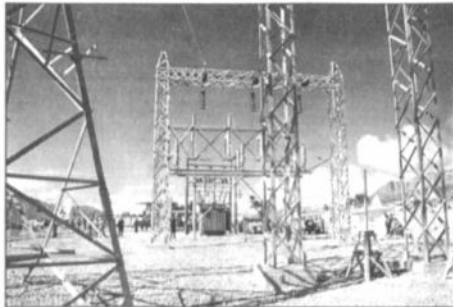
La subestación de Mallasa proveerá de energía eléctrica a 114 comunidades
