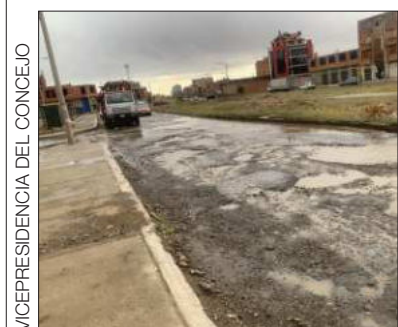
Una vía deteriorada en El Alto.
