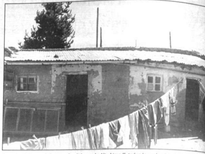
En inmediaciones de las tres fundidoras de Alto Lima II, todas las calaminas de las viviendas están corroídas por efecto de los gases tóxicos.
