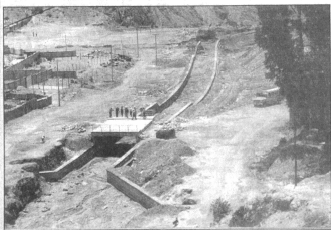
La canalización del río Huayhaja en alto Cota-Cota (zona Sud), fue construida sin autorización de la Alcaldía y la alcaldesa Mónica Medina aseguró hace un mes "que ella en persona la demolerá en 48 horas". ¿Qué está esperando?...
