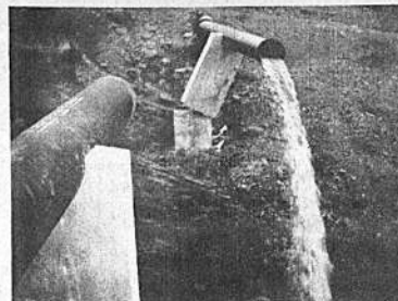
Una de las tuberías de aducción de agua se desconectó en la Zona de la Esperanza, en Chuquisaca, cortando el suministro de agua a la población de Sucre. En la fotografía, uno de los accionistas sostiene una parte de la tubería dañada.
