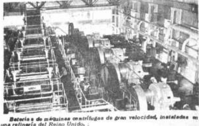
Baterías de máquinas centrifugas de gran velocidad, instaladas en una refinera del Reino Unido.
