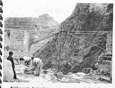
Está a punto de terminar un extenso programa de dotación de servicios públicos en provincias. Sistemas de captación de agua potable, como el que se aprecia en la fotografía, han sido construidos en todas las capitales de provincia y otras poblaciones importantes. El programa se encuentra en plena ejecución y habrá de llenar una senda necesidad en las poblaciones del Departamento de Chuquisaca.
