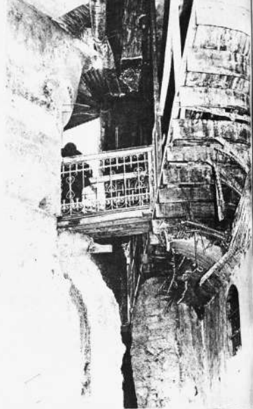
Así es el Panóptico de San Pedro por dentro, todo se derrumba por la acción de los años, poniendo en peligro la vida de más de 200 personas.
