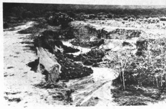
La fotografía muestra parte del canal principal del sistema de riegos de Villamontes, que se encuentra completamente deteriorado. Los daños, a medida que transcurre el tiempo, aumentan en razón de las torrenciales lluvias que caen en la zona.
