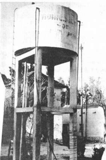
Este es el tanque para agua potable que está instalado en la Plaza Central del pueblo de Colcapirhua de ahí se distribuye agua a todo el pueblo
