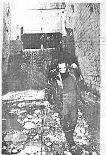
El Alcalde Olmos aparece durante el recorrido por los corredores de la matriz del alcantarillado de La Paz. Pudo observar las graves deficiencias existentes.
