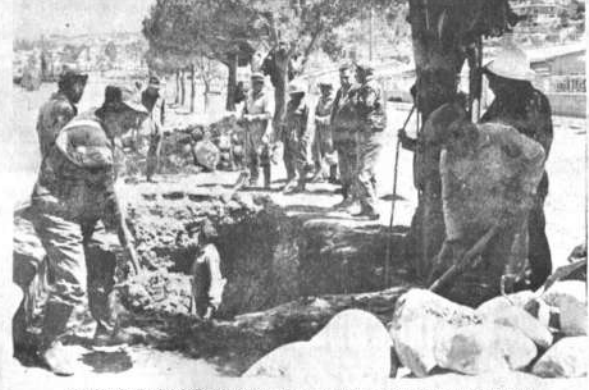
HUNDIMIENTO EN AVENIDA ROMA. Suspendivamente se produjo ayer un hundimiento en la Avenida Roma, en la parte sur del Barrio del Periodista. Este hecho alarmó a la población de esa zona y se inició la evacuación. El Alcalde, Cdr. Heriberto Olivos, en persona y acompañado de sus inmediatos colaboradores, se constituyó de inmediato en dicho barrio y ordenó la evacuación urgente de la parte afectada. Como medida preventiva, después la suspensión del tránsito por esa avenida, sólo por la ruta de subida, se le hacia por la avenida Itasca. La parte de bajada no tuvo dificultad alguna. Autoridades municipales dijeron que el hundimiento de dicha parte de la avenida se debe a deficiencias de construcción de una torre-torera.
