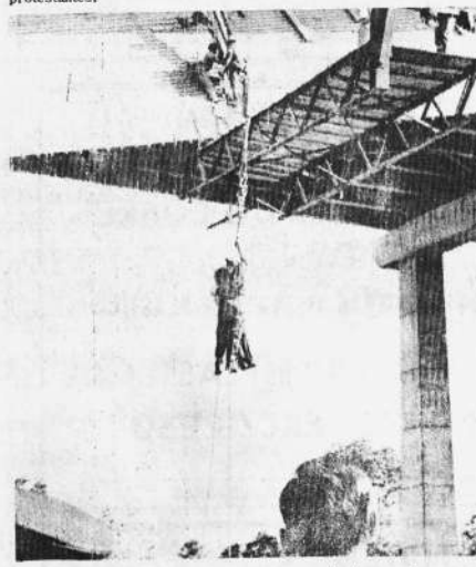
RESCATE. Trabajadores de rescate son izados para llegar donde uno de los varios obreros que se hallan pendientes del puente interestatal Maine-New Hampshire para automotores. Cuatro obreros perecieron al caer desde andamios de la construcción. (Kittery, Maine, Radiofoto AP)
