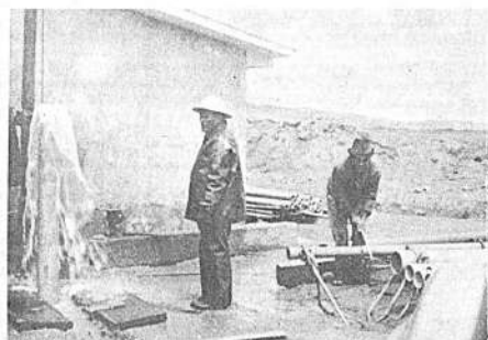
Pozo surgente perforado por CORPAGUAS en la localidad de Tiahuanacu, construido con fondos provenientes del préstamo N° 154-SF-BO (BID).
