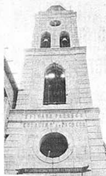
La Torre de la Parroquia "Santo Domingo", cuyas paredes internas se encuentran totalmente húmedas y con peligro de derrumbarse, debido al deteriorado sistema de desagüe.
