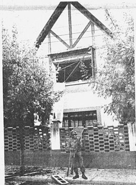
DESPUES DE LA EXPLOSION.- Este es el aspecto exterior del dormitorio de la pareja Alexander-Dupleich. La ventana fue arrancada de cuajo y expulsada por la violencia de la explosión hacia la calle. Sobre el árbol y la verja cuelga la persiana y al pie del guardia armado hay restos de la ventana de madera. El techo de la casa voló en parte.
