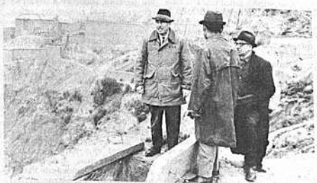
DERRUMBE EN ALTO MIRAFLORES.- El personal dependiente de la Dirección de Aguas Potables y Retén de Emergencia de la Municipalidad, después de intenso trabajo, logró reparar parcialmente la rotura del canal de aducción de suministro de la zona de Miraflores. El Alcalde Municipal, Hugo Suárez Guzmán, inspeccionó personalmente los trabajos de reparación de dicho canal, afectado por un avaria de 8 a 15 horas y se dijo que es probable que a partir de hoy se normalice totalmente el servicio de agua a las zonas de Miraflores y Obrajes.
