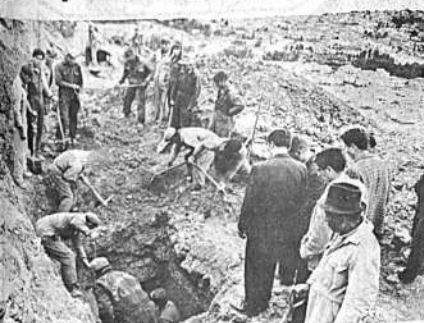
Trabajadores municipales trabajan en lugar del asentamiento de tierra ocurrido en la parte final de Alto Miraflores, produciendo el Palvoro. El asentamiento fracturó el canal de aducción de agua potable privando de ese servicio a la zona de Miraflores.
