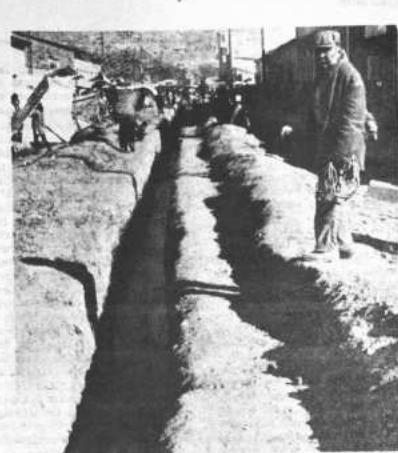
En las zonas marginadas la ausencia de servicios públicos como ser el alcantarillado con el esfuerzo combinado de ciudadanos y autoridades se está tratando de remediar.
