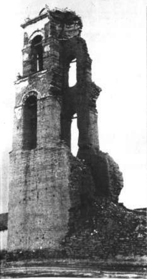
La torre de Paria, construida en 1535, está en peligro de derrumbarse.
