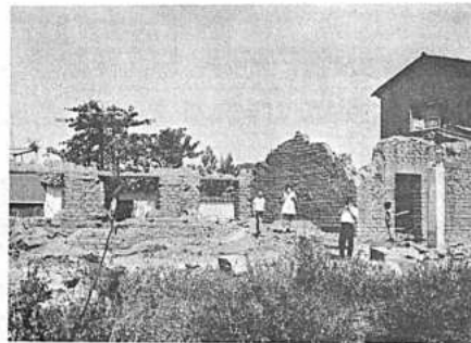
Este es el estado que presenta uno de los edificios a medio construir y que está destinado para un centro educacional. Por falta de recursos económicos están paralizados los trabajos y los estudiantes tienen que sufrir directamente este abandono. Camiri tiene una población escolar aproximada de 8,000 niños y jóvenes.
