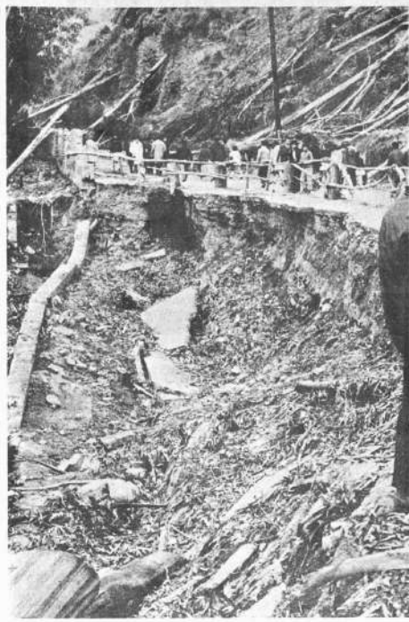
Un estrecho camino bordeado por una rústica balaustrada es todo lo que queda de la autopista a Obrajes. El asfalto, descansando sobre terreno removido, amenaza venir abajo en cualquier momento. El antiguo muro de contención siguió la dirección del deslizamiento y ha resultado a varios metros de donde se levantaba originalmente.
