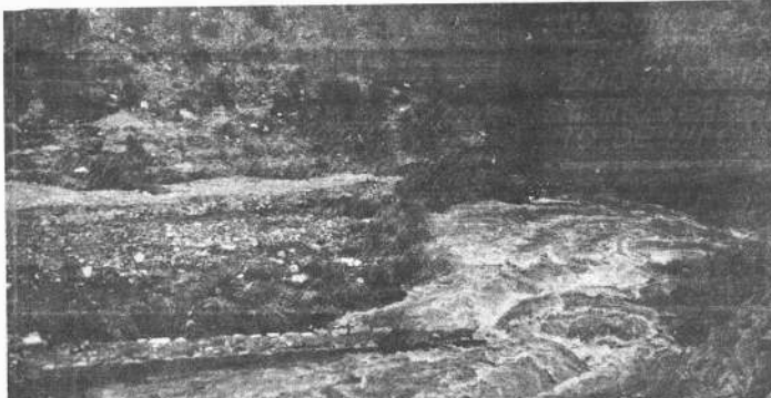
El torrentoso Choqueyapu, que ya una vez se desbordó y arrasó con la antigua y hoy desaparecida calle Recreo. A la altura de la calle Ravelo, ha quedado destruida la canalización y ahora las aguas de ese río siguen un curso caprichoso, comiéndose las riberas e iniciando peligroso proceso de erosión.
