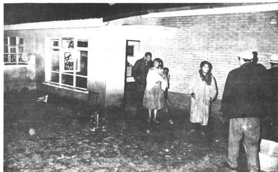
La casa de la familia Alborta fue una de las mayormente afectadas por la inundación del sábado en la noche en el Barrio del Periodista. Todo quedó bajo varios centímetros de lodo. La parte oscura en la pared, muestra la altura a la que llegó el agua que penetró a las habitaciones destruyendo muebles y poniendo en riesgo la vida de varios menores.
