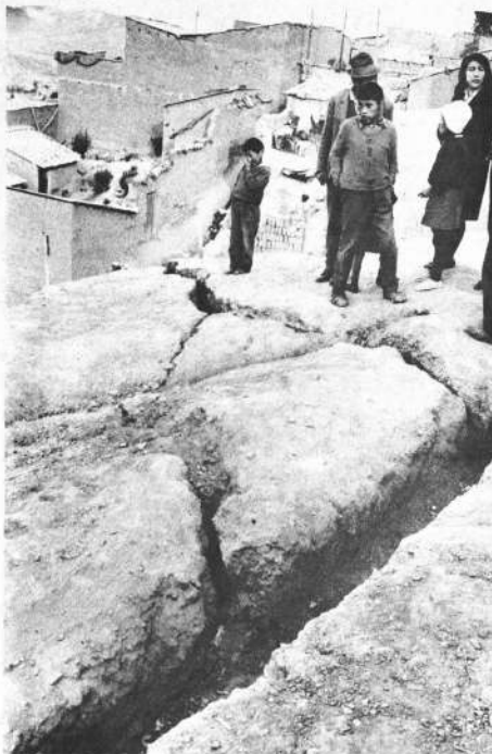
Los grietas pueden producir el desplome de varias viviendas en Villa Nueva Potosí, si no se toman medidas inmediatas para conjurar el peligro, al parecer originado por las excavaciones para construir un depósito de agua.
