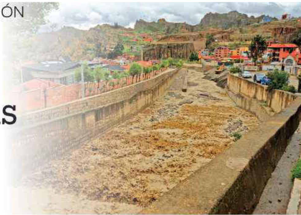
AFECTADOS. Falta de combustible evita el envío de maquinaria para limpieza y habilitación de caminos.
