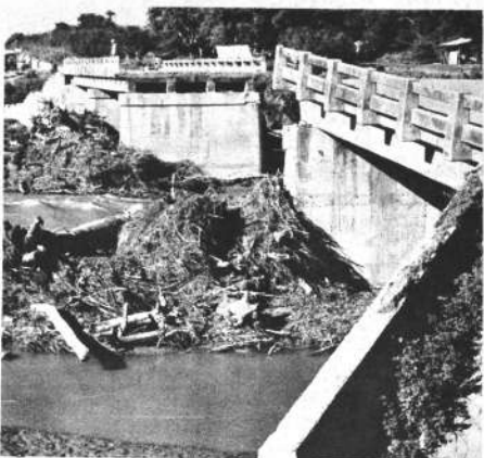
El puente Tarumá, a 450 kilómetros de Píra, en Santa Cruz, será una de las principales obras de reparación que se efectuará dentro de poco. El costo de la obra ha sido avaluado en 225.000 dólares.
