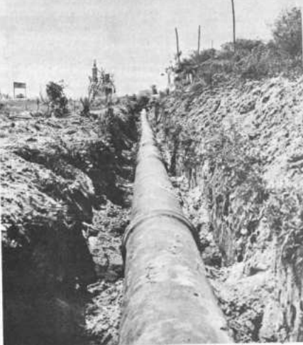
Red de agua potable en Santa Cruz
