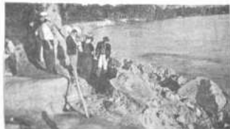
Dstrucción de una parte del puente. A raíz de este desastre, la obra ha quedado paralizada indefinidamente. Der. Las inundaciones regulares del río Yapacaní y la falta de jerricos, ha ocasionado que el puente a medio construir quede al centro del río. (Foto NIKKA)
