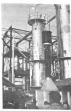
Una parte de la moderna planta de lubricantes que ha sido inaugurada en Cochabamba. Tiene una capacidad de producción de 300 toneladas diarias. Su costo es de 400 mil dólares.
