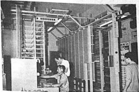
Parte de la sala de operaciones telefónicas. Los modernos equipos japoneses trabajan con gran precisión. Sus instalaciones están construidas con proyecciones para el futuro. (Foto NIKKA)
